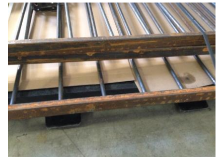
2. Rost auf Geländerelement
